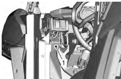
1. Boîte à fusibles avant
