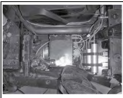
COMPRESSOR DA ACS
